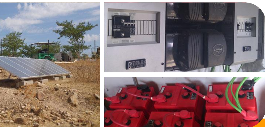
Instalación Solar Fotovoltaica Aislada para vivienda
