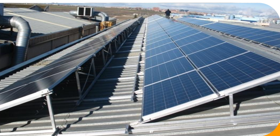
Instalación Solar Fotovoltaica de 50 kW sobre cubierta
