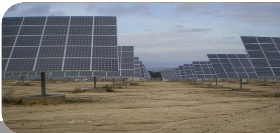
Parque Solar Fotovoltaico de 2.600 kW con seguimiento a dos ejes
