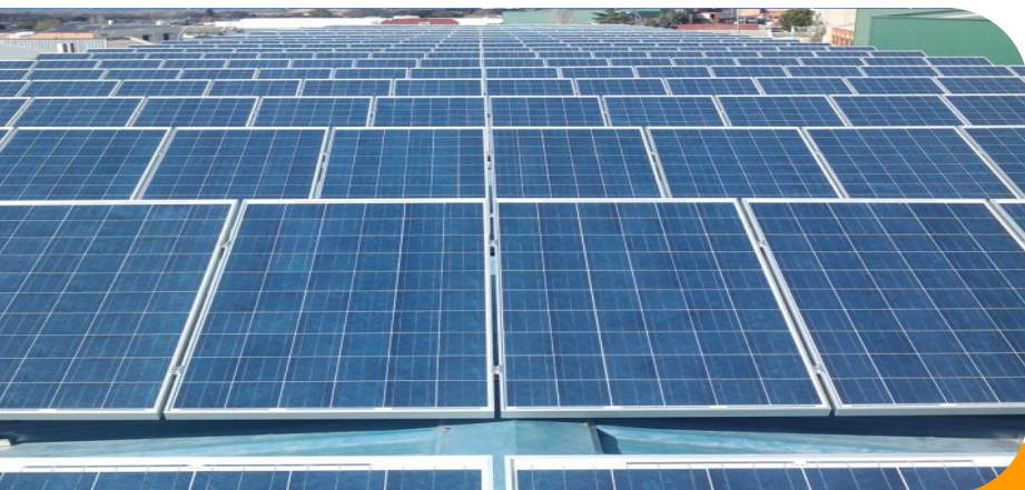
Instalación Solar Fotovoltaica de 98 kW sobre cubierta
