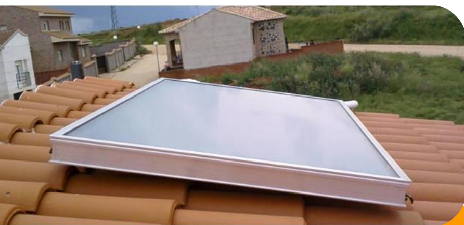
Energía Solar Térmica vivienda unifamiliar
