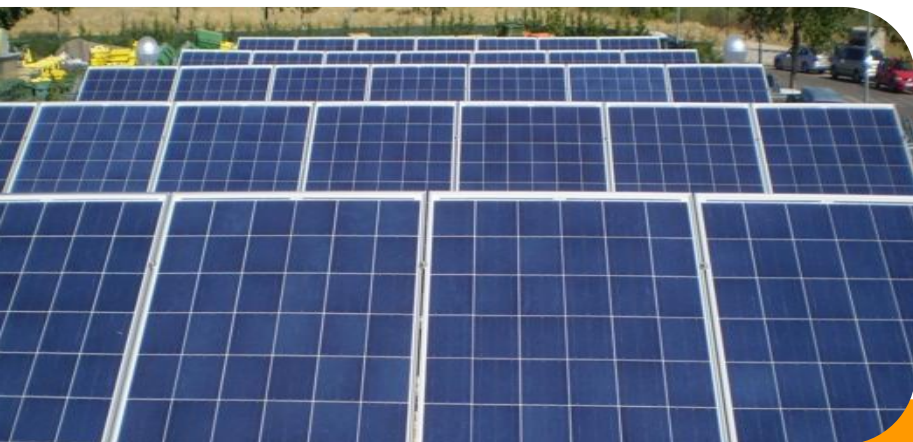
Instalación Solar Fotovoltaica de 15 kW sobre cubierta
