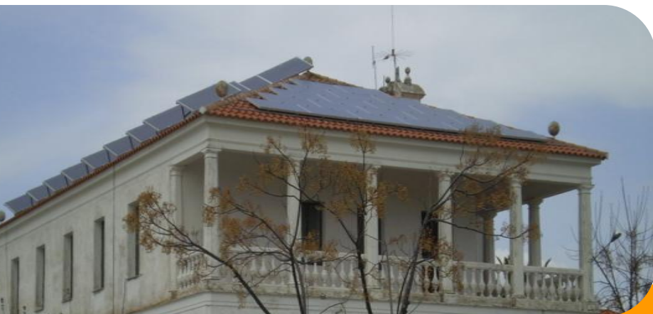
Instalación Solar Fotovoltaica de 10 kW sobre cubierta
