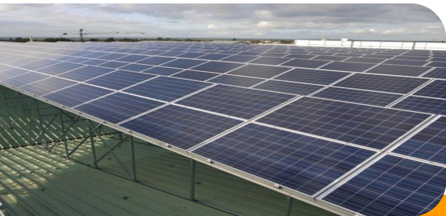
Instalación Solar Fotovoltaica de 175 kW sobre cubierta
