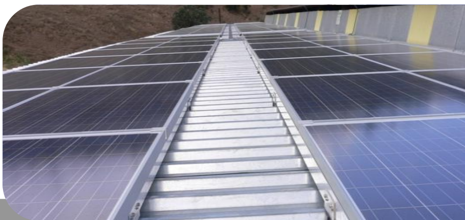
Instalación Solar Fotovoltaica de 19,95 kW sobre cubierta
