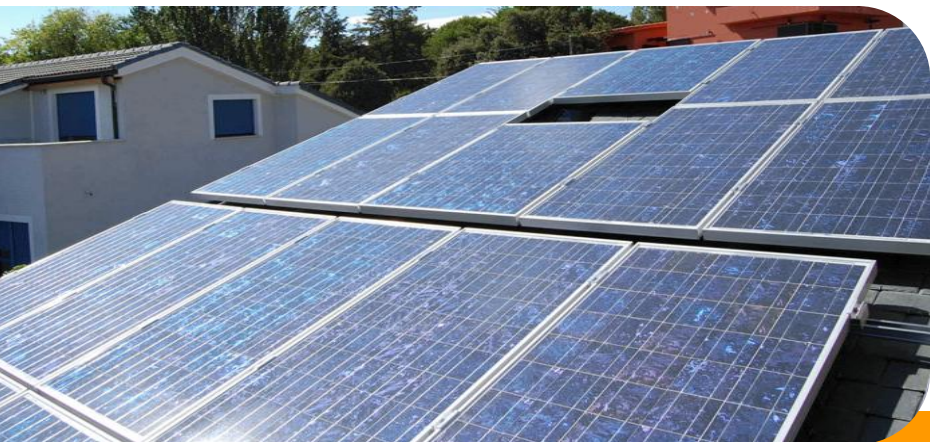
Instalación Solar Fotovoltaica de 6,45 kW sobre cubierta de vivienda
