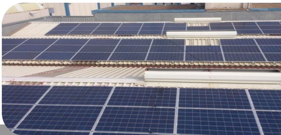
Instalación Solar Fotovoltaica de 100 kW sobre cubierta
