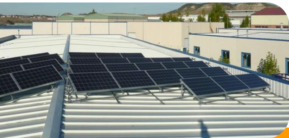
Instalación Solar Fotovoltaica de 8,4 kW sobre cubierta
