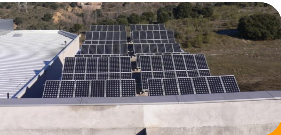
Instalación Solar Fotovoltaica de 30 kW sobre cubierta
