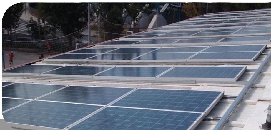
Instalación Solar Fotovoltaica de 15 kW sobre cubierta
