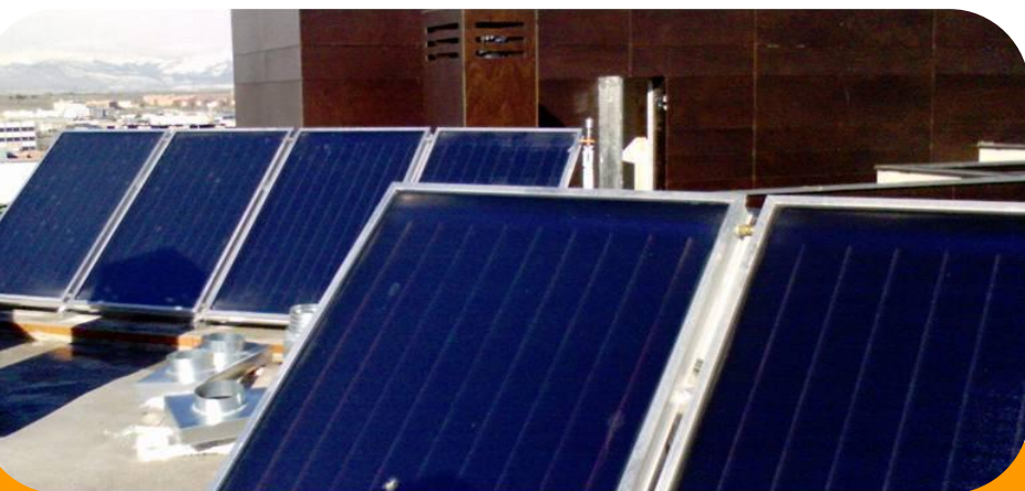
Energía Solar Térmica 35 viviendas multifamiliares
