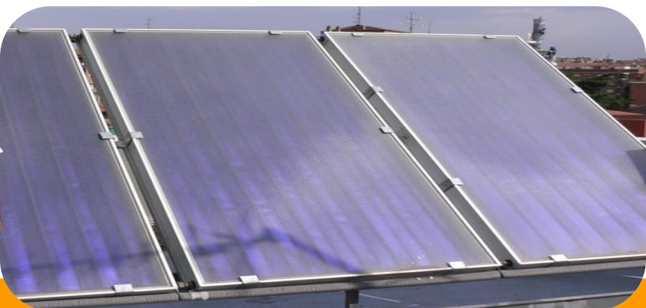
Energía Solar Térmica 5 viviendas multifamiliares
