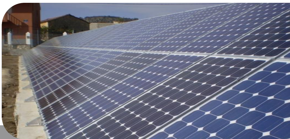
Instalación Solar Fotovoltaica de 30 kW sobre suelo
