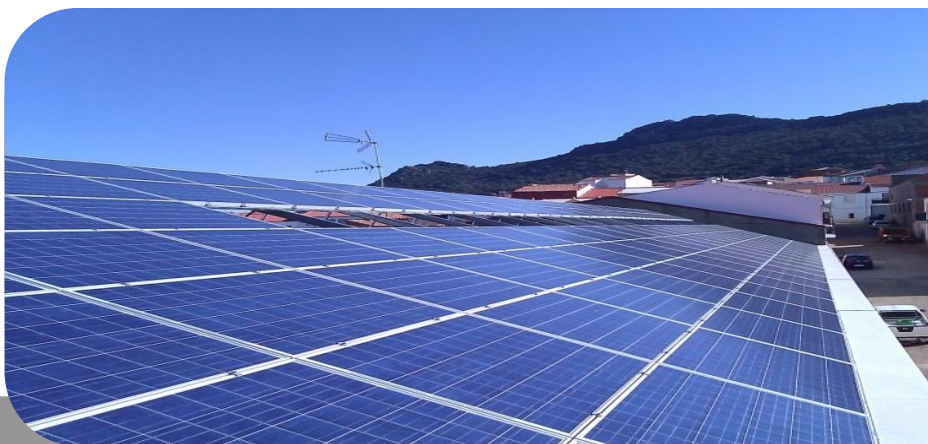
Instalación Solar Fotovoltaica de 30 kW sobre cubierta
