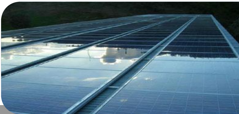
Instalación Solar Fotovoltaica de 80 kW sobre cubierta
