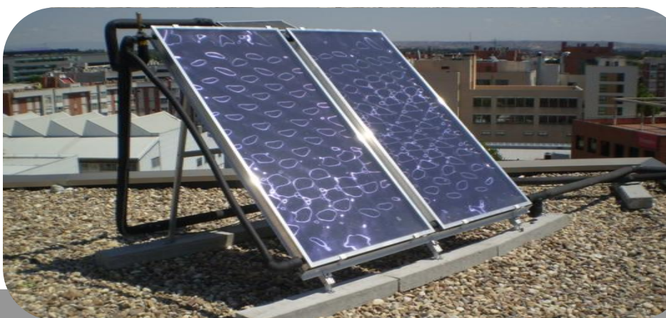
Energía Solar Térmica edificio de oficinas
