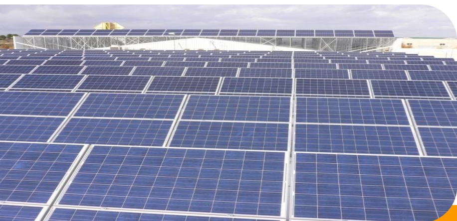
Instalación Solar Fotovoltaica de 150 kW sobre cubierta
