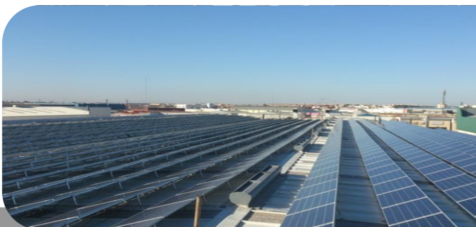
Instalación Solar Fotovoltaica de 400 kW sobre cubierta
