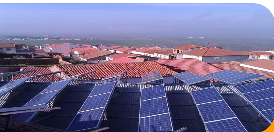
Instalación Solar Fotovoltaica de 10 kW sobre cubierta
