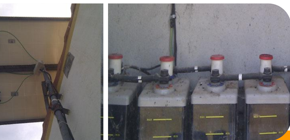
Instalación Solar Fotovoltaica Aislada para vivienda
