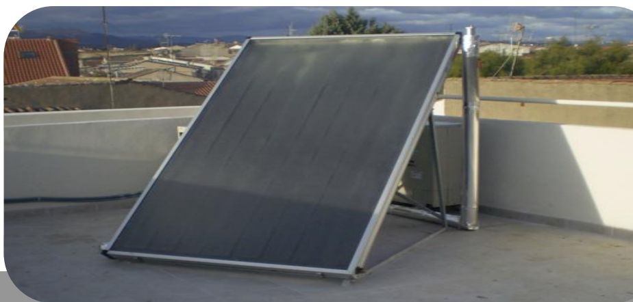
Energía Solar Térmica vivienda unifamiliar
