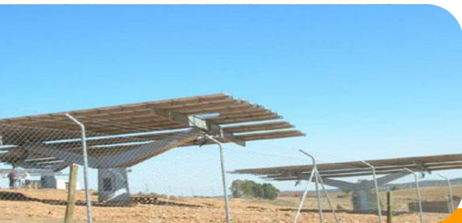
Parque Solar Fotovoltaico de 100 kW con seguimiento a dos ejes
