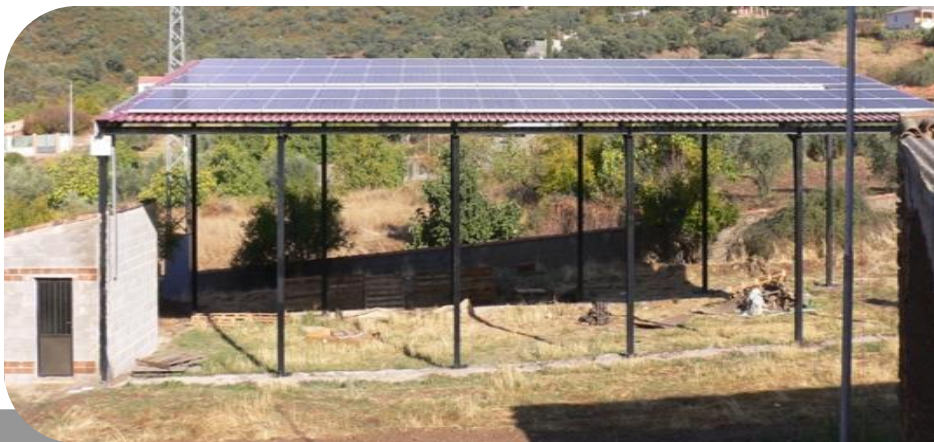
Instalación Solar Fotovoltaica de 20 kW sobre cubierta
