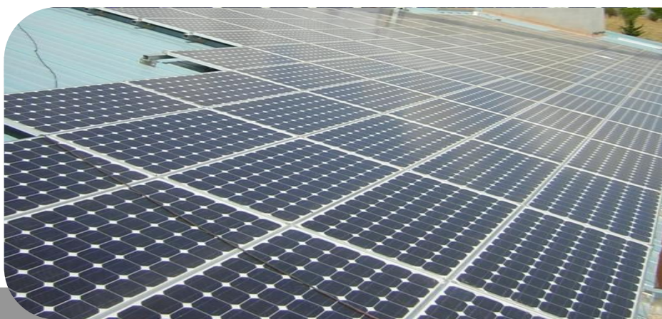
Instalación Solar Fotovoltaica de 55 kW sobre cubierta
