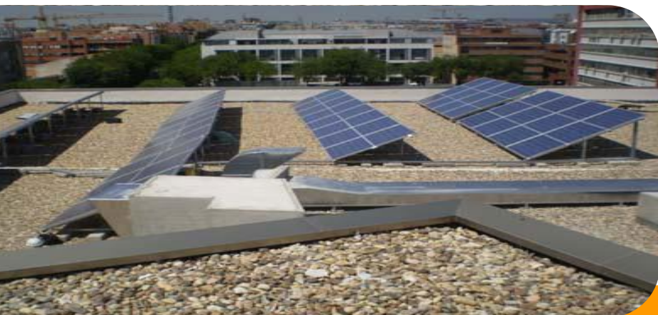
Instalación Solar Fotovoltaica de 20 kW sobre cubierta
