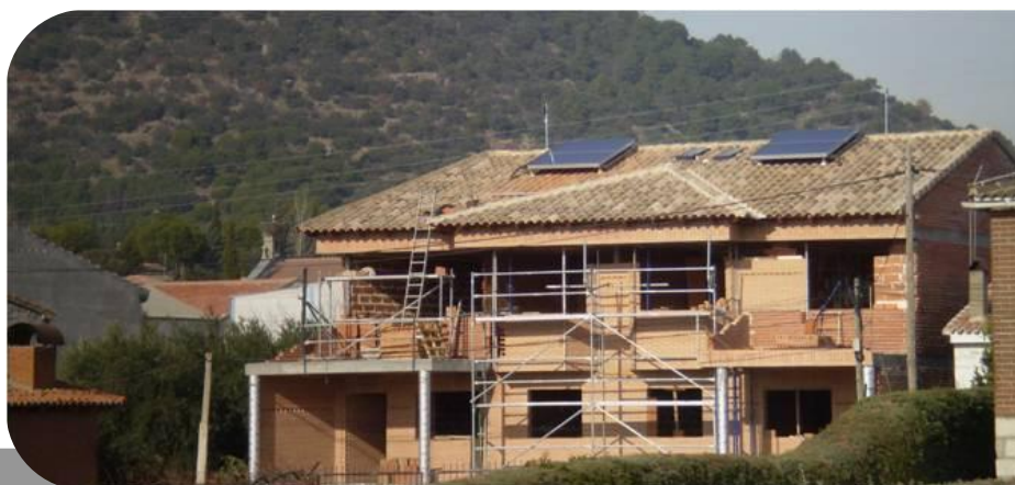
Energía Solar Térmica 2 viviendas unifamiliares
