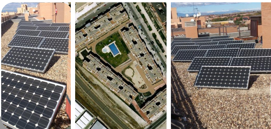
9 Instalaciones Solares Fotovoltaicas de 5 kW sobre cubierta
