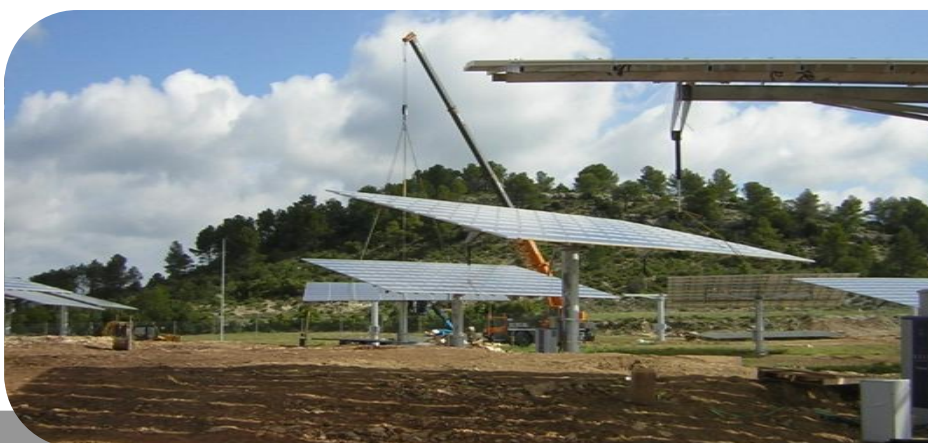
Parque Solar Fotovoltaico de 470 kW con seguimiento a dos ejes
