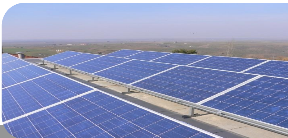
Instalación Solar Fotovoltaica de 10 kW sobre cubierta
