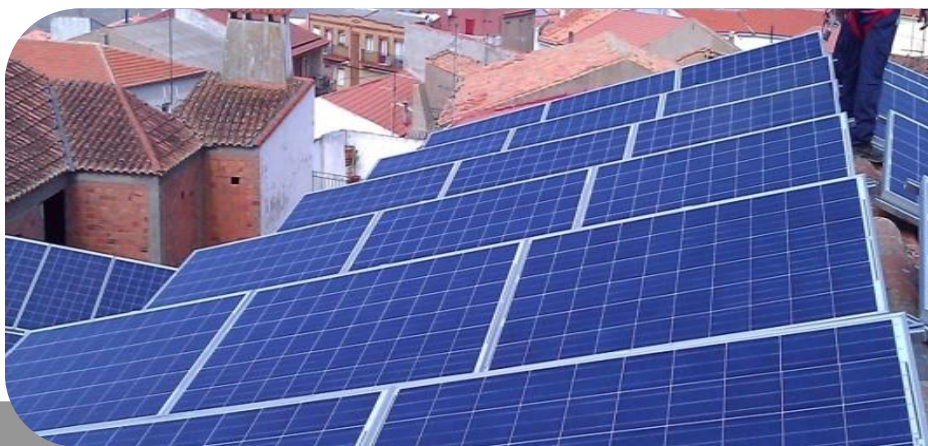
Instalación Solar Fotovoltaica de 10 kW sobre cubierta
