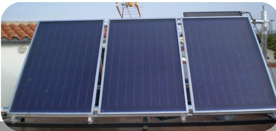
Energía Solar Térmica 5 viviendas multifamiliares
